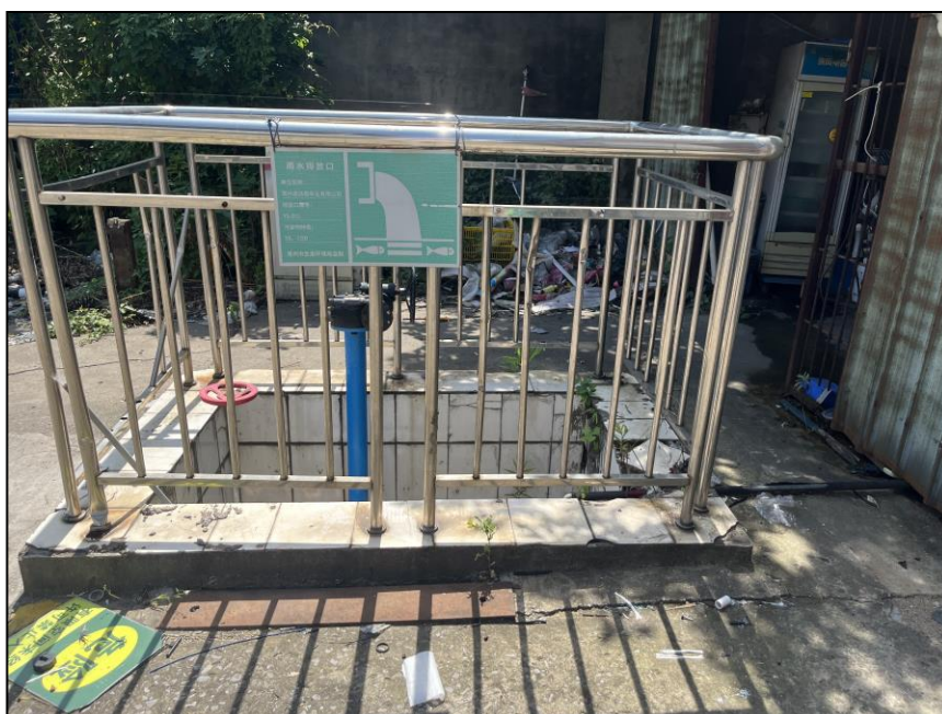
厂区东北角处雨水排放口和应急阀门井
